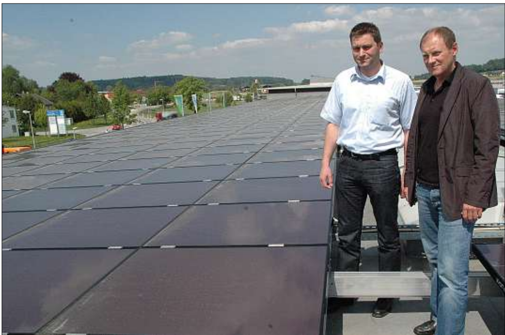
Für die Bluenergy-Gesellschafter Wolfgang Straubinger (links) und Jürgen Löblein ist die Energiewende längst Realität: Die Solar-Module auf dem Firmengebäude leisten als Kraftwerke bei Sonnenschein ganze Arbeit. – Foto: Bernhard Furtner
